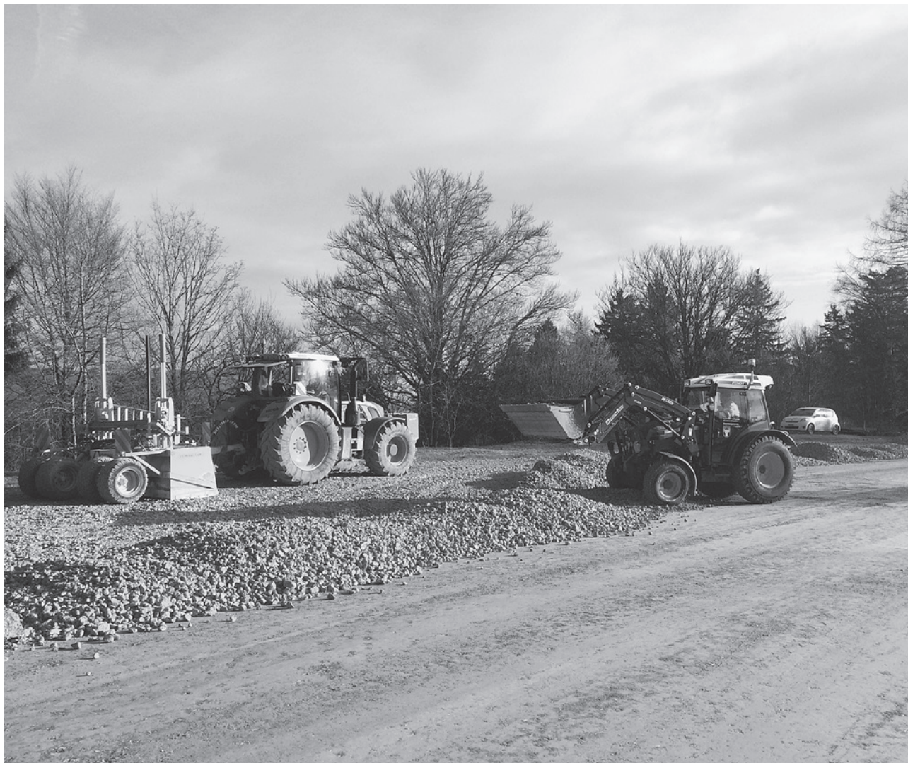
Im Herbst 2015 nahm die Gemeinde die Totalsanierung des Parkplatzes Hohmatt in Angriff.
