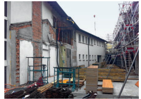
An der Fassade des bestehenden Schulhauses werden die Durchbrüche für den Anschluss der Passerellen gemacht.
