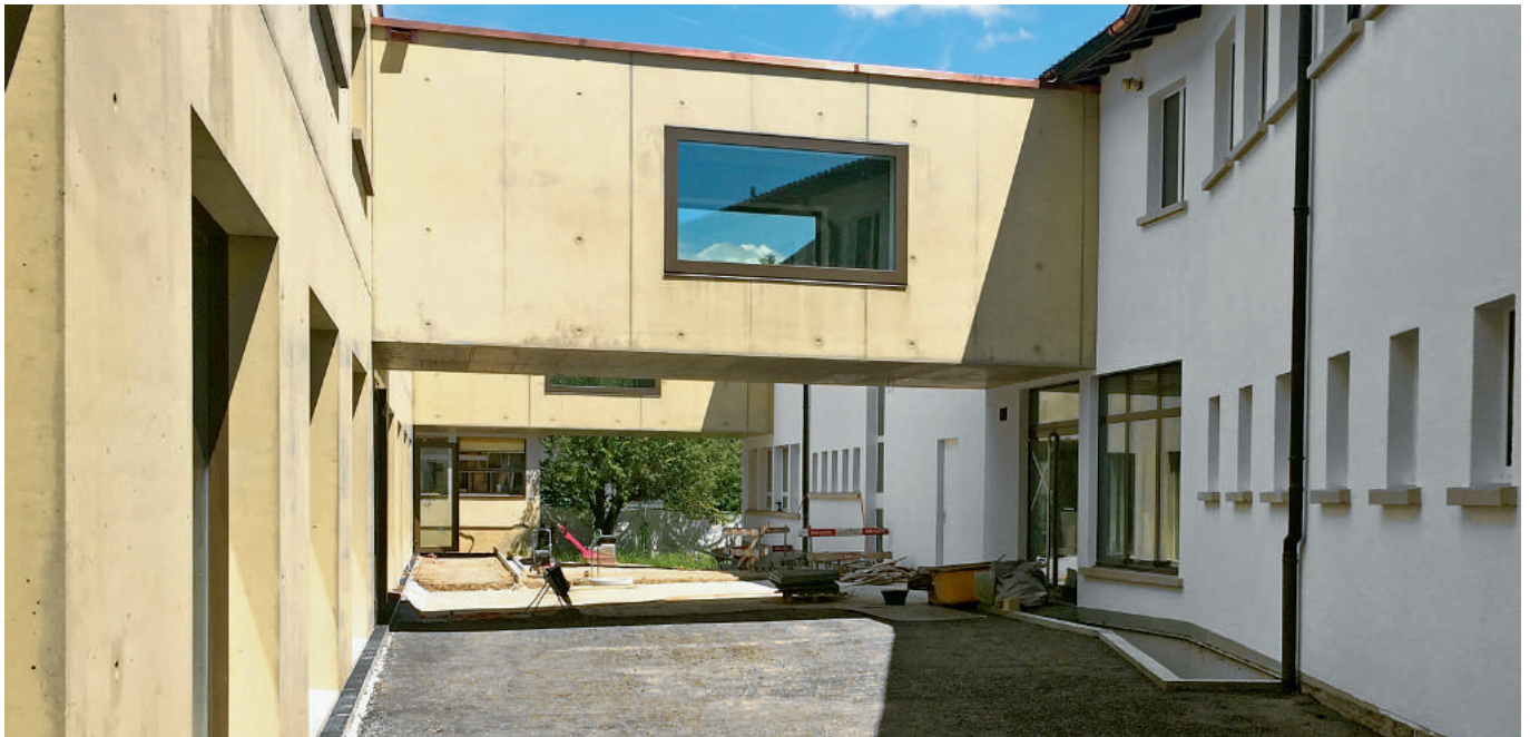
Zwischen dem Neubau und dem Altbau spannt sich der Innenhof. Ein erster Blick durch den fast fertig gestellten Pausenhof lässt erahnen, wie die Kinder diesen beleben werden.
