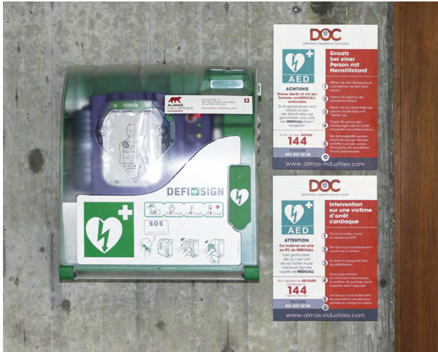
Der Defibrillator, beim Eingang der Gemeindeverwaltung.
